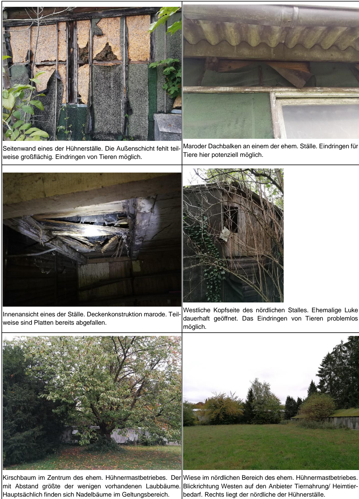
Abbildung 5: Fotodokumentation (Quelle: Ingenieur- und Planungsbüro LANGE GbR, Oktober 2018)
