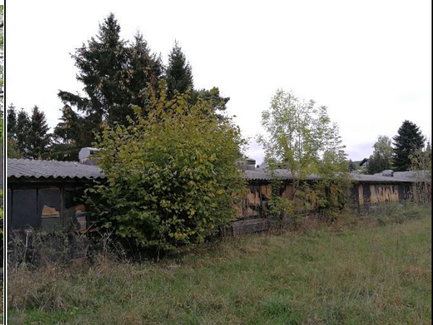
Gelände des ehem. Hühnermastbetriebs: Der mittlere der Hühnerställe. Die Verkleidung der Seitenwände ist teilweise stark zerstört. Hier finden sich zahlreiche potenzielle Nischen.
