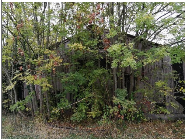
Gelände des ehem. Hühnermastbetriebs. Westliche Kopfseite des südlichen Hühnerstalls. Einige der Latten fehlen. Eindringen für Tiere hier problemlos möglich.
