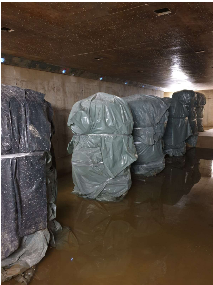
Bereich Aktivkohlefilter - Untergeschoss
