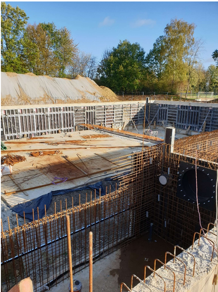
Bereich Schwallwasserbehälter und Schwimmerbecken
